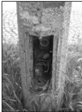
Brak zabezpieczenia wnęki bezpiecznikowej na słupach oświetleniowych
