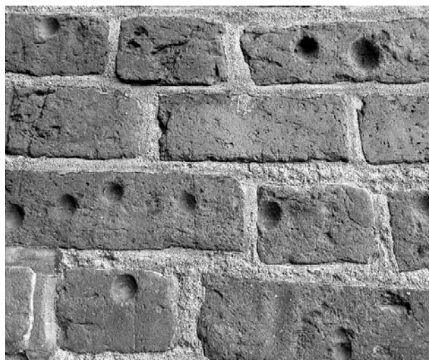
Ślady dołkowe i pręgi na południowej elewacji konkatedry św. Jakuba Apostoła w Olsztynie, przy głównym wejściu do świątyni / fot. Gabriela Semenowicz
